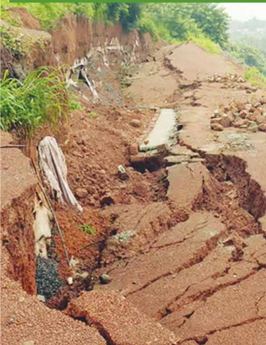
कन्नूर । इलायचूर में नेशनल हाईवे के निर्माण के तहत बनाई जा रही सड़क का एक हिस्सा भूस्खलन के कारण क्षतिग्रस्त हो गया। इससे निर्माण स्थल पर मलबा जमा हो गया और सड़क का एक हिस्सा प्रभावित हुआ।
