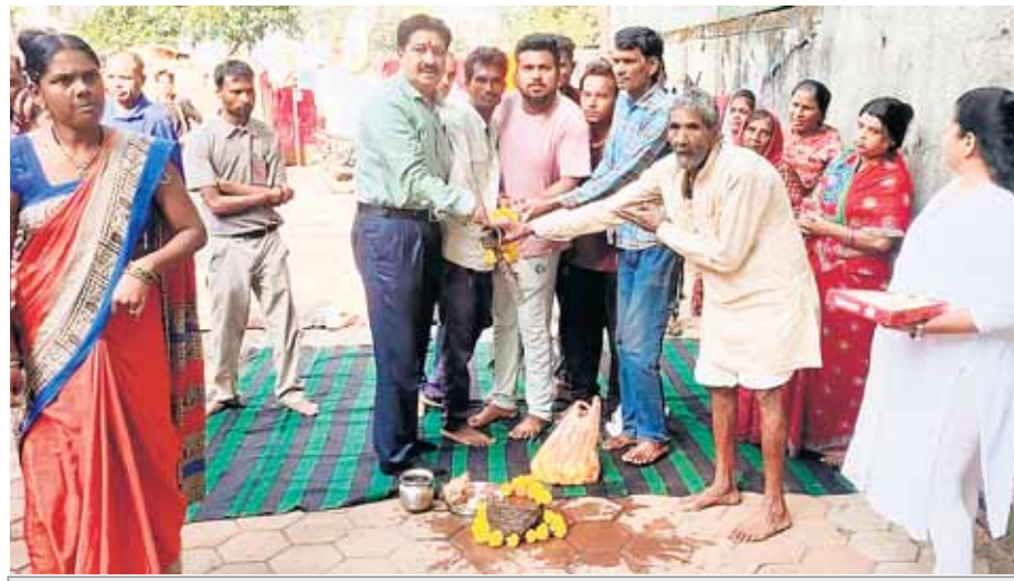
अब हर घर पहुंचेगा स्वच्छ और निर्मल जल... आज क्षेत्रीय पार्षद योगेंद्र सिंह गुड्ड चौहान ने वार्ड 46 ऋषि नगर झुग्गी बस्ती में घर-घर जल पहुंचाने हेतु पाइप लाइन डाले जाने के लिए भूमि पूजन किया।
