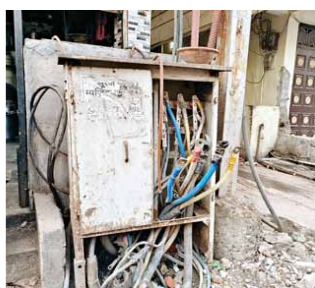
वाला भी नहीं मिलता। केविल कौन बदलेगा: गर्मी खत्म होने के बाद मॉनसून के सीजन में अंडर ग्राउंड केविल से लाइट गुल होना तय माना जा रहा है। आदर्श मार्ग के निर्माण के
